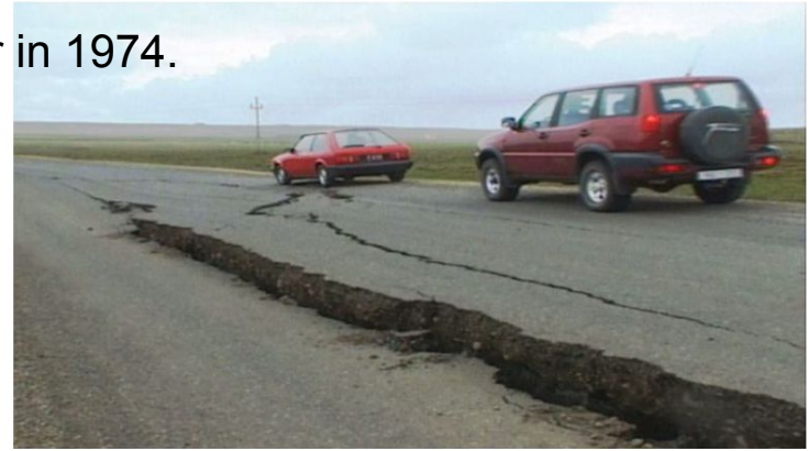
Suðurlandsvegur eftir skjálfta í júní árið 2000.
